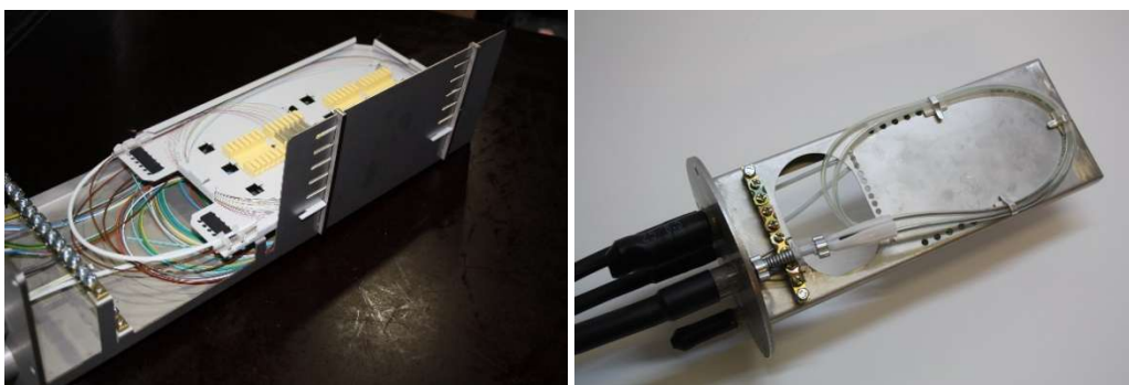
Kuva 7.1.10. Keskiputkirakenteiset kaapelit tuotuna jatkoskoteloon sekä jatkoskaappiin.
