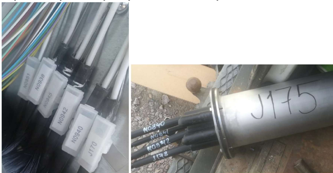
Kuva 7.1.2. Kaapeleiden ja jatkojen merkitseminen.
